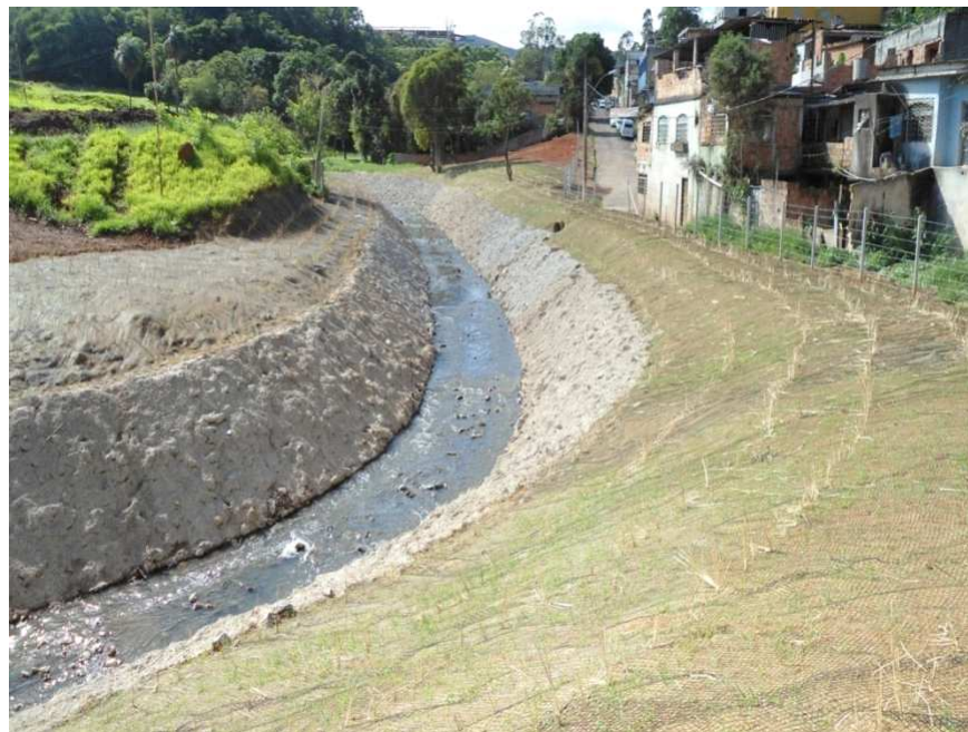
Figura 4.33 – Vista do Córrego Bonsucesso, próximo à Rua Terezinha França, após a conclusão das intervenções
