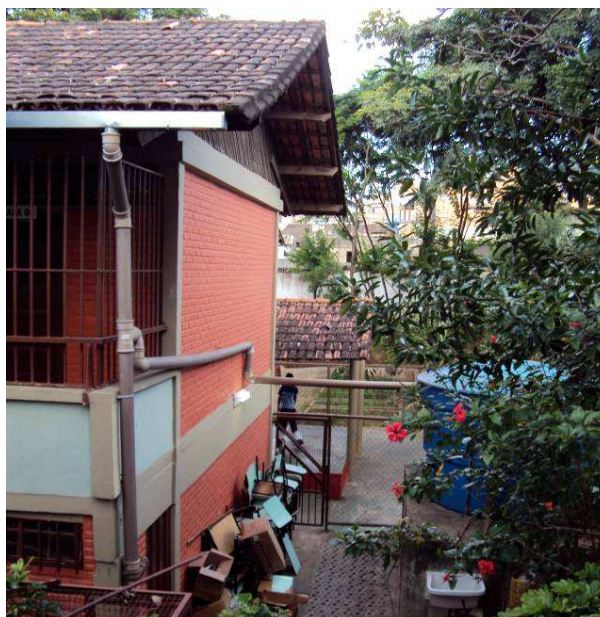
Figura 6.9 – Sistema de captação de água de chuva na Escola Anne Frank
