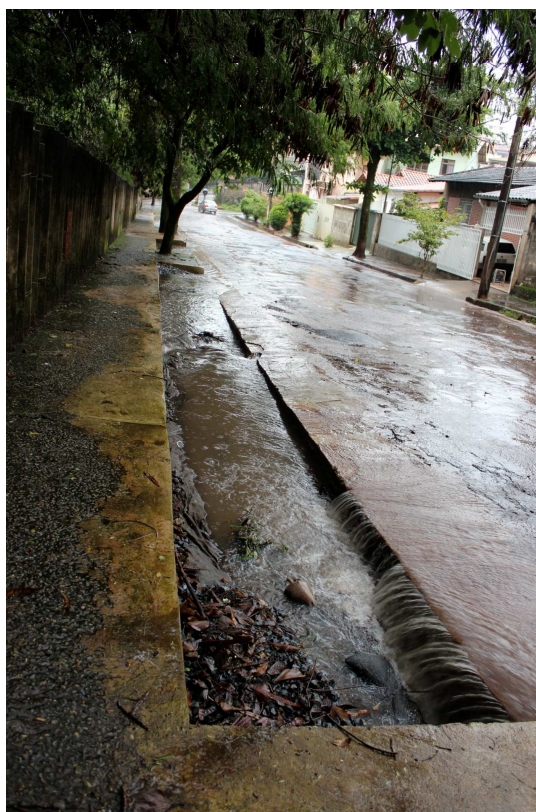
Figura 6.6 – Entrada do escoamento lateral no sistema de trincheiras
