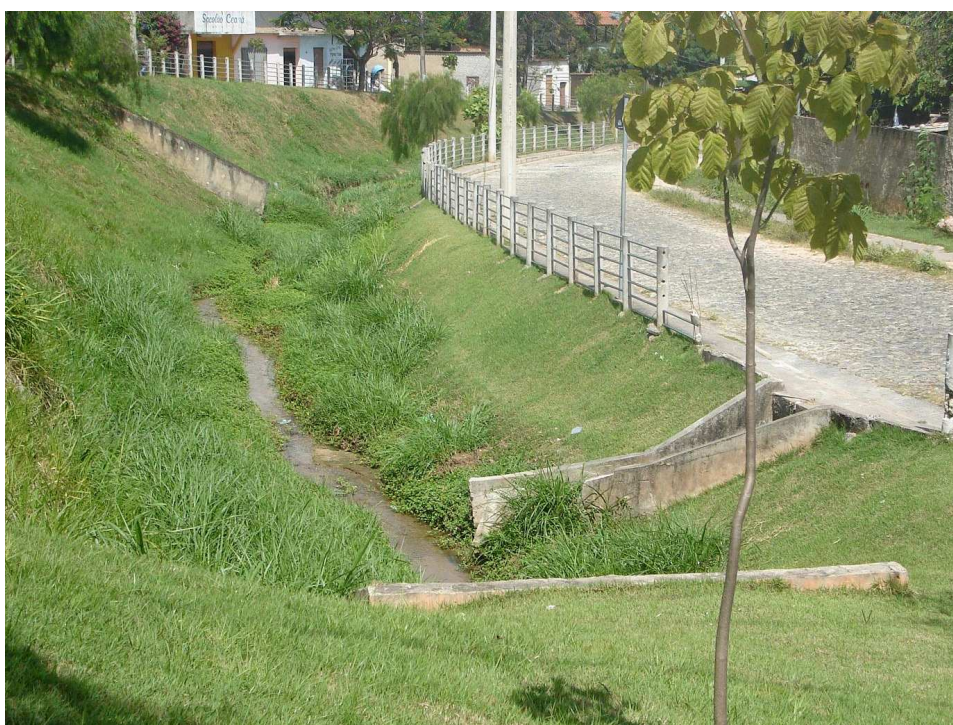
Figura 4.9 – Vista do Córrego da Avenida Baleares a jusante do Parque (obra concluída)
